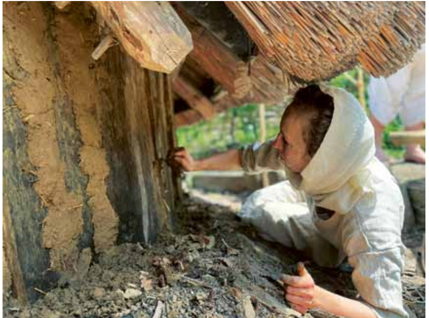
Abb. 24: Die frische Lehmmischung wird zwischen die Bretter der Wand geschmiert. Foto: Anna Mitsou Förster © Förderverein Museumsdorf Düppel The fresh clay mixture is smeared between the boards of the wall.
